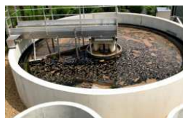
Boues station d'épuration
